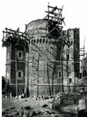
Restauration de la tour Saint-Laurent, fin XIX e , médiathèque de l'architecture et du patrimoine
